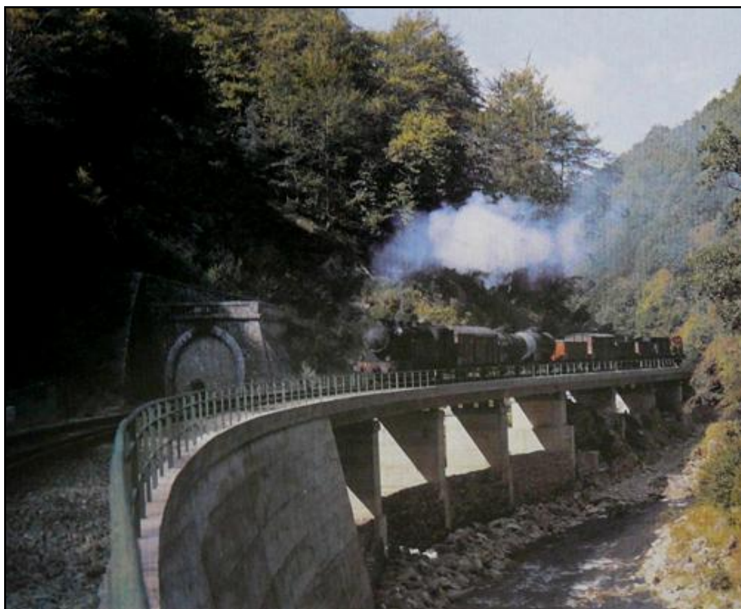
La déviation terminée et la sortie murée du tunnel La sortie avec son drain est ici bien visible. La végétation n'a pas encore repris possession des lieux
